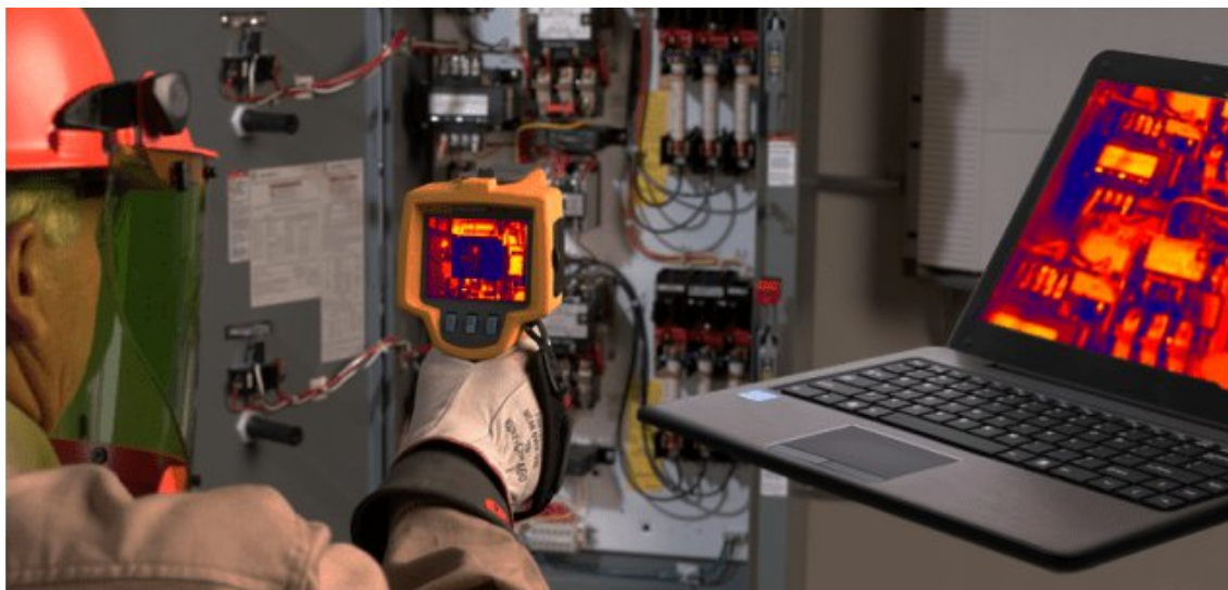
Рисунок 20. Пример проведения тепловизионного контроля электрошкафа
